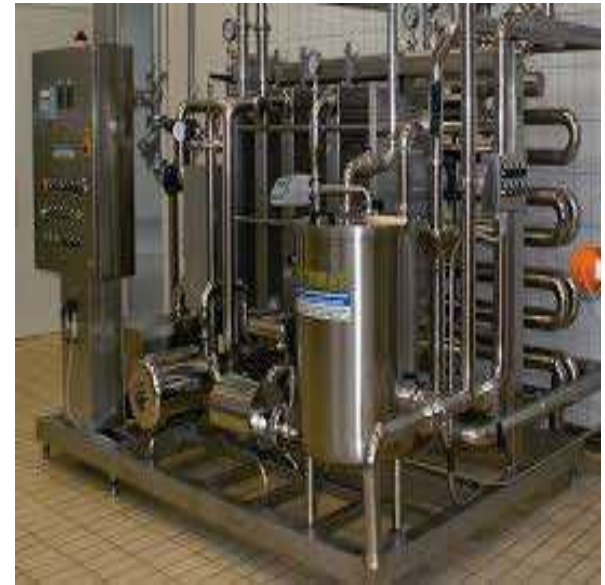
Heat exchanger untuk memproduksi susu pasteurisasi/UHT
